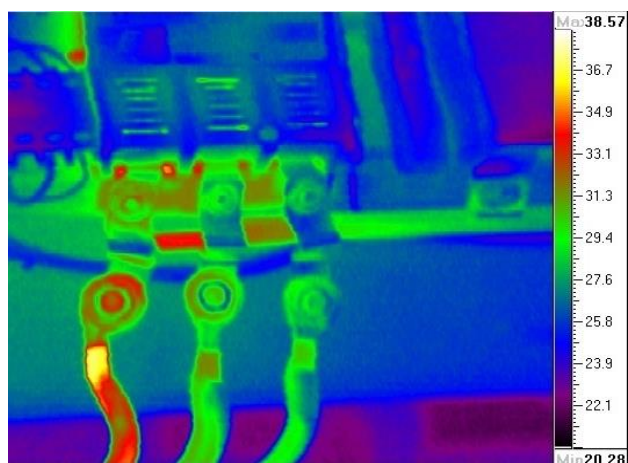
Рисунок 21. Пример термограммы контактных соединений с температурной шкалой
